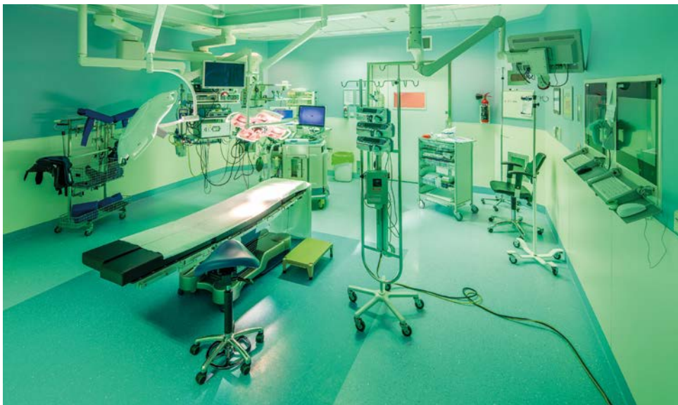
De activiteiten van Winkels Techniek in de zorg concentreren zich onder meer op het adviseren en realiseren van hoogwaardige technische oplossingen voor onder meer high cure-afdelingen en OK's.
